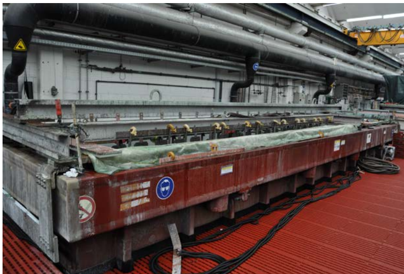
Der POLIGRAT Lohnbetrieb in Pfungstadt bietet u.a. ein Elektropolierbad von 10 m Länge mit dem Elektrolyten E 269 im Einsatz
